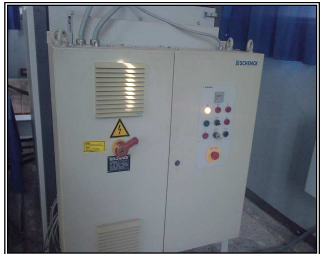
La partie électrique d'Hydropuls
